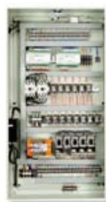
電控箱裝置 Electrical Cabinet
